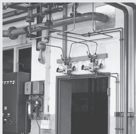
Überwachung auf Fett- und Öleinbruch in zwei getrennten Kondensatrückläufen
